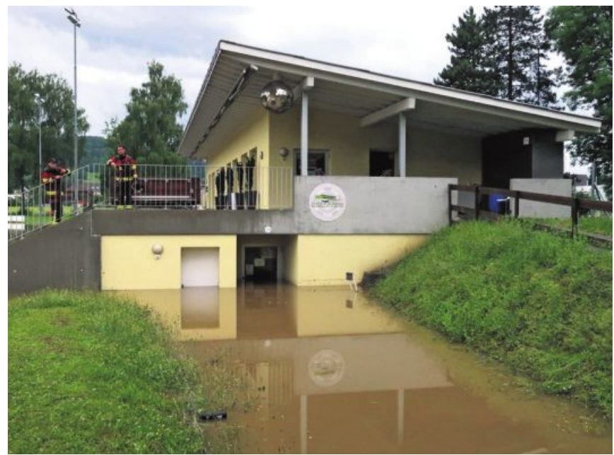
Reiden: Den Sportclub Reiden treffen die Niederschläge hart: Das Hauptspielfeld wird überflutet, in den Kabinen steht das Wasser meterhoch.
