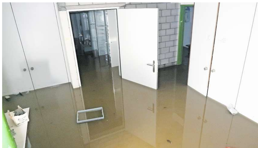
Die Fluten drangen in den Technikraum der kürzlich renovierten Badi Reiden ein.
